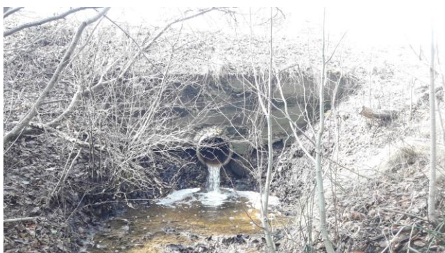
Pilt 3 – 20240327 Väike-Koru eesvoolu kraavi K-1 betoontruubi d0,45 m väljavool 11184 Alliku-Laagri-Hüüru teel. Truubi betoonist portaal on vajunud kaldu ja selle alumine osa on murenenud.
